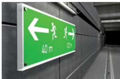
Знаки аварийного выхода в туннелях
